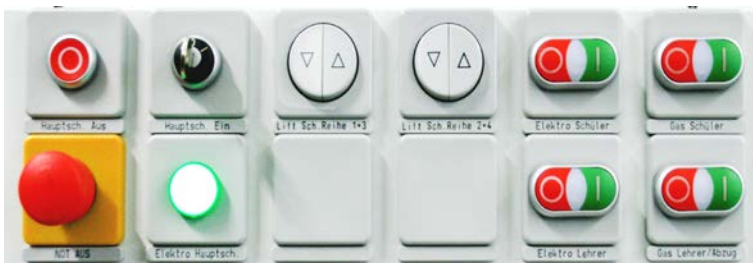
Abb. 18 Tableau mit Trenneinrichtung
